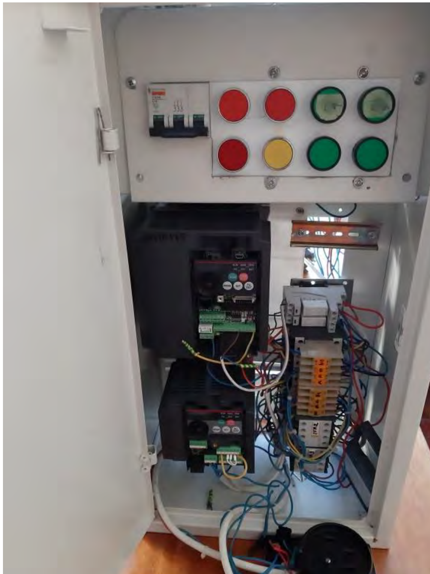
Рис. 4.11. Вигляд електрощитка з частотними перетворювачами
