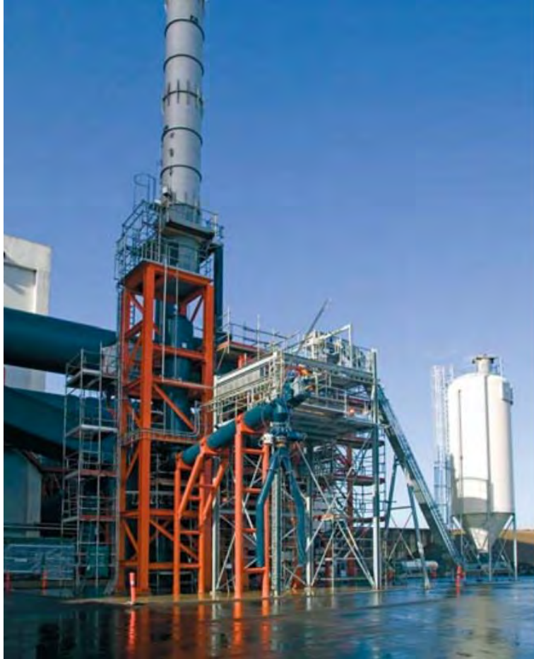
Рис. 7.22. Газифікаційна установка потужністю 6 МВт в м. Калундборг (Данія)
