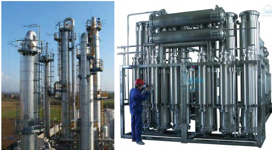
Рис. 3.9. Загальний вигляд ректифікаційної колони та багатоклонного дистилятора
