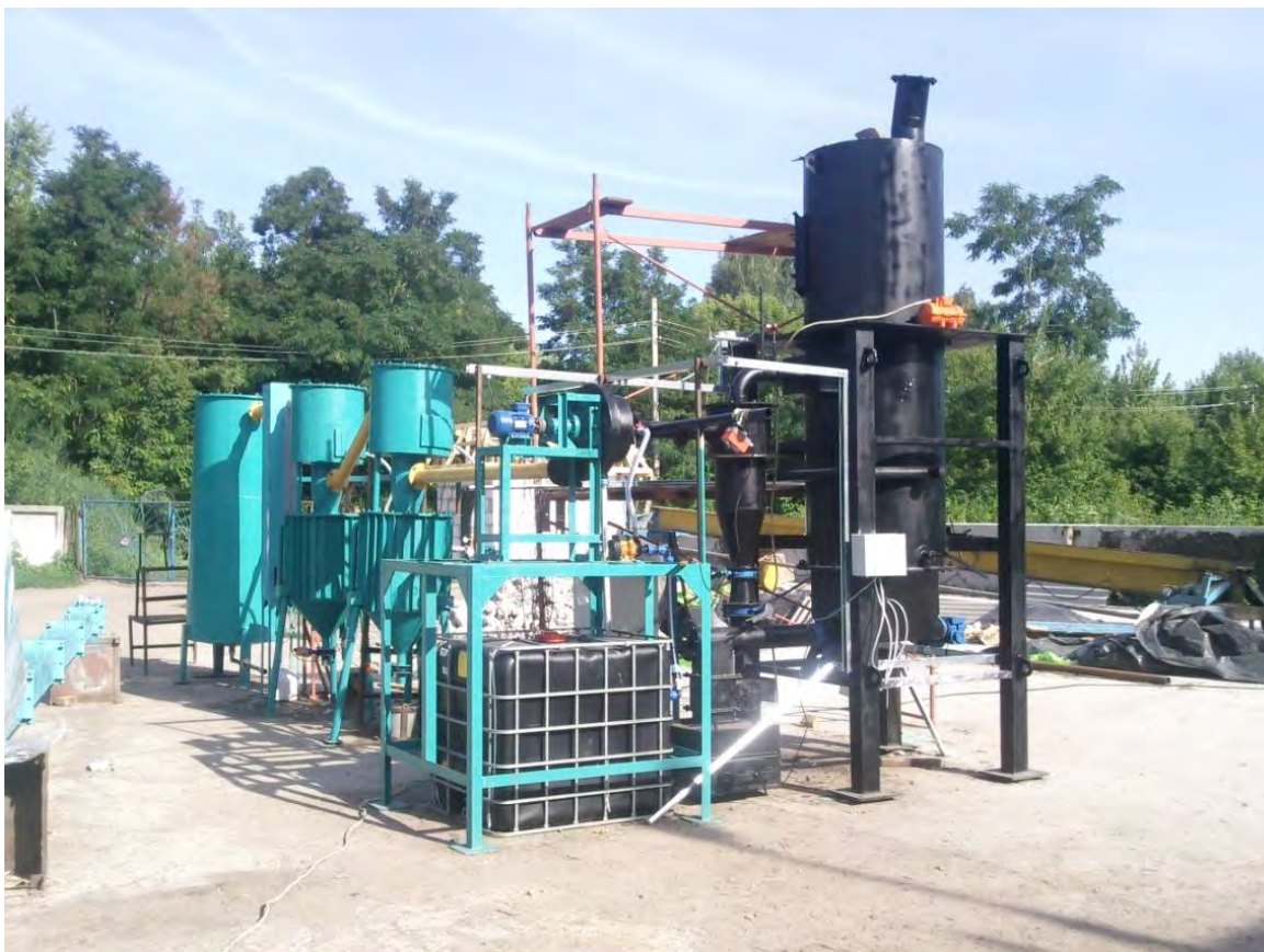
Рис. 7.15. Електрогазогенераторна установка фірми «Наша Енергія» (Україна) марки УГК-100
