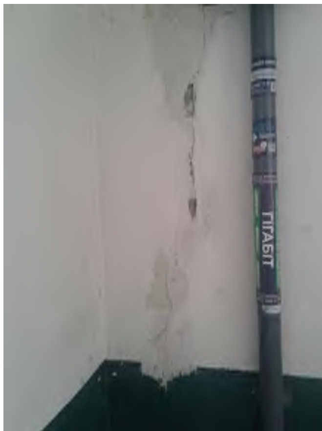
Рис. 4.32. Стан залізобетонної стіни у будинку на Оболоні після землетрусу 1977 р. Фото 2020 р.
