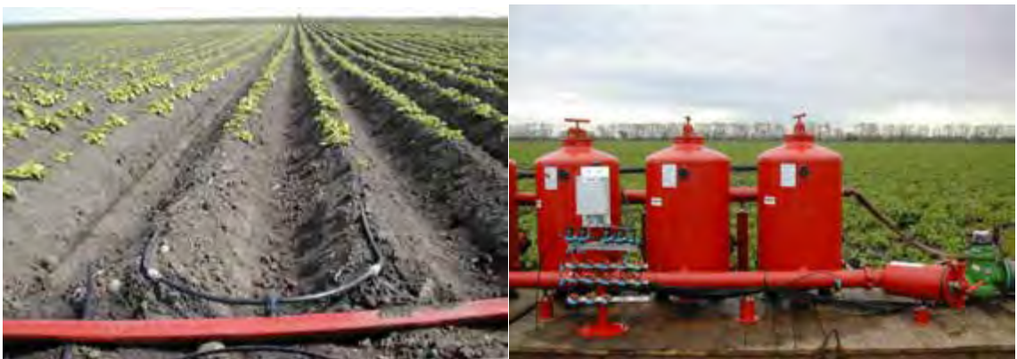
Рисунок 8.24. Краплинне зрошення картоплі: а) ліворуч – краплинні лінії і розподільний трубопровід; б) праворуч – фільтри для крапельного зрошення
