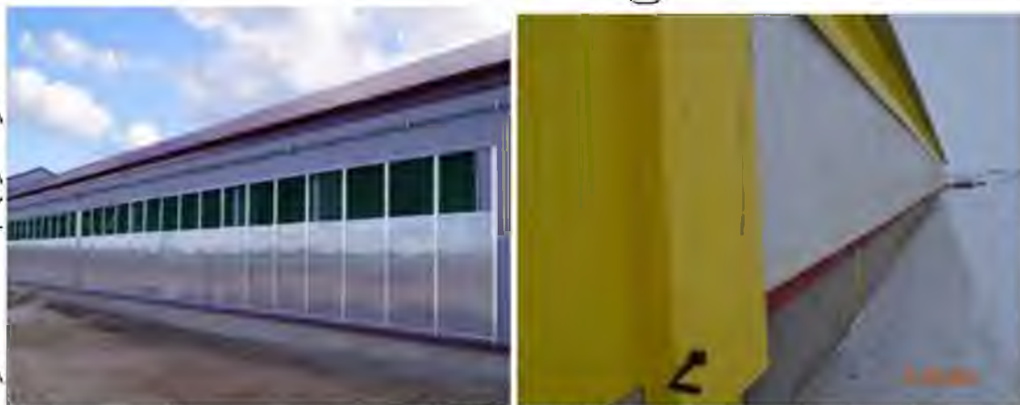
Рис. 4.3. Вентиляційні штори на стінах корівника
