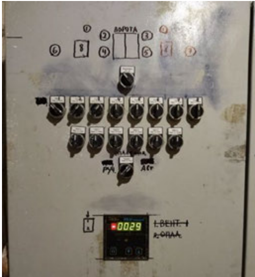
Рис.3.6. Система керування опалення та вентиляцією у пташнику
