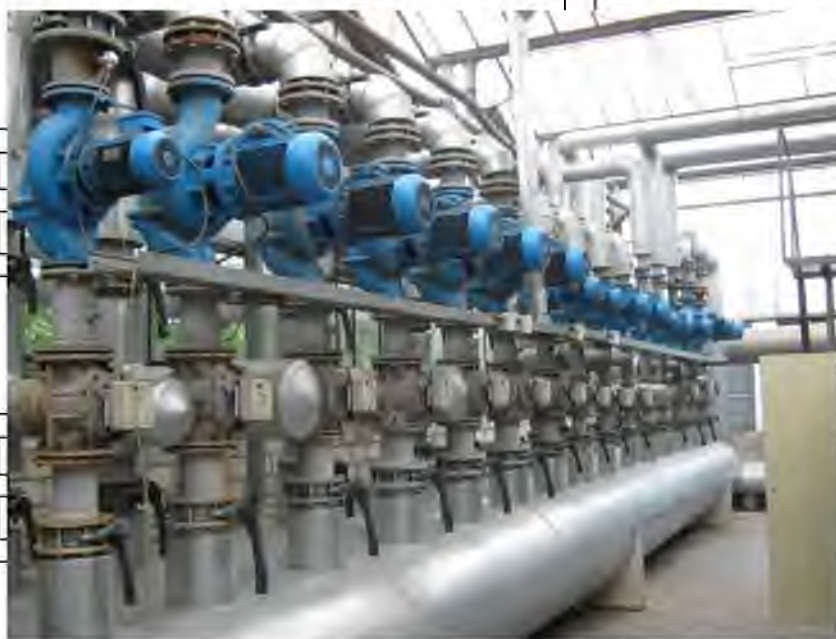
Рис. 2.6. Зовнішній вигляд блоку управління системою опалення (ПІАТ Комбінат Тепличний)
