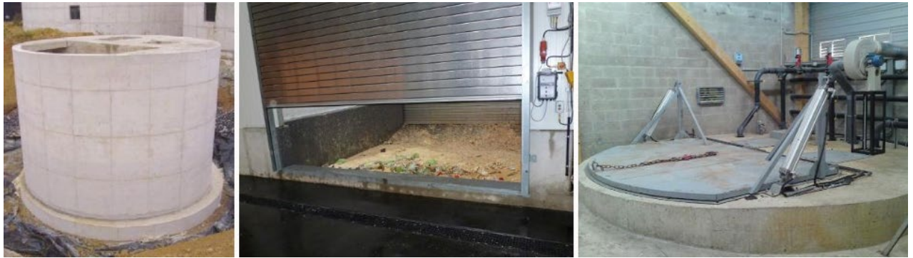
Рис. 1.10. Приймальні резервуари систем подачі сировини
