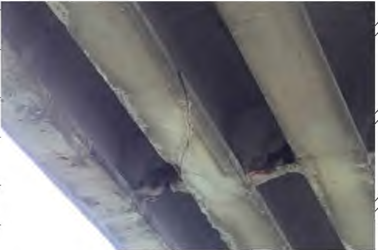
Рисунок 7.6 – Похила наскрізна тріщина нижньої полицки з розривом дротів поперечно напруженої арматури балки Б2 прогонової будови 2-3
