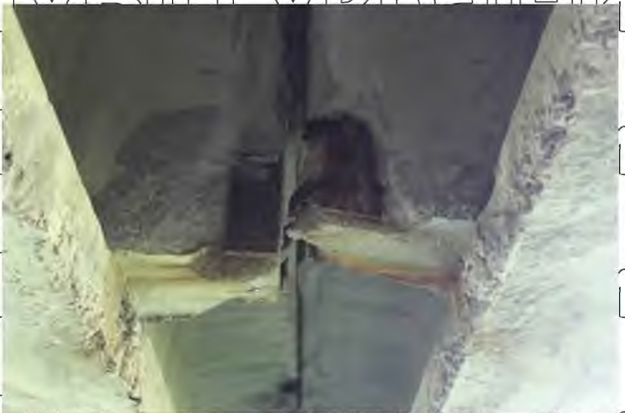
Рисунок 7.7 – Обрив накладок об'єднання напівдіафрагм балок Б1-Б2 у прогоні 5-6
