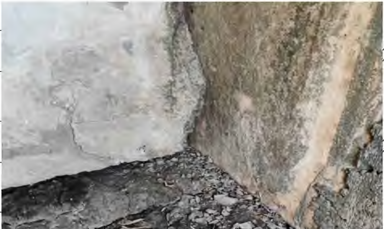
Рисунок 7.8 – Недостатнє значення зазору між балкою Б1 у прогоні 1-2 та шафовою стінкою опори 1. Незначні сколи захисного шару бетону балки
