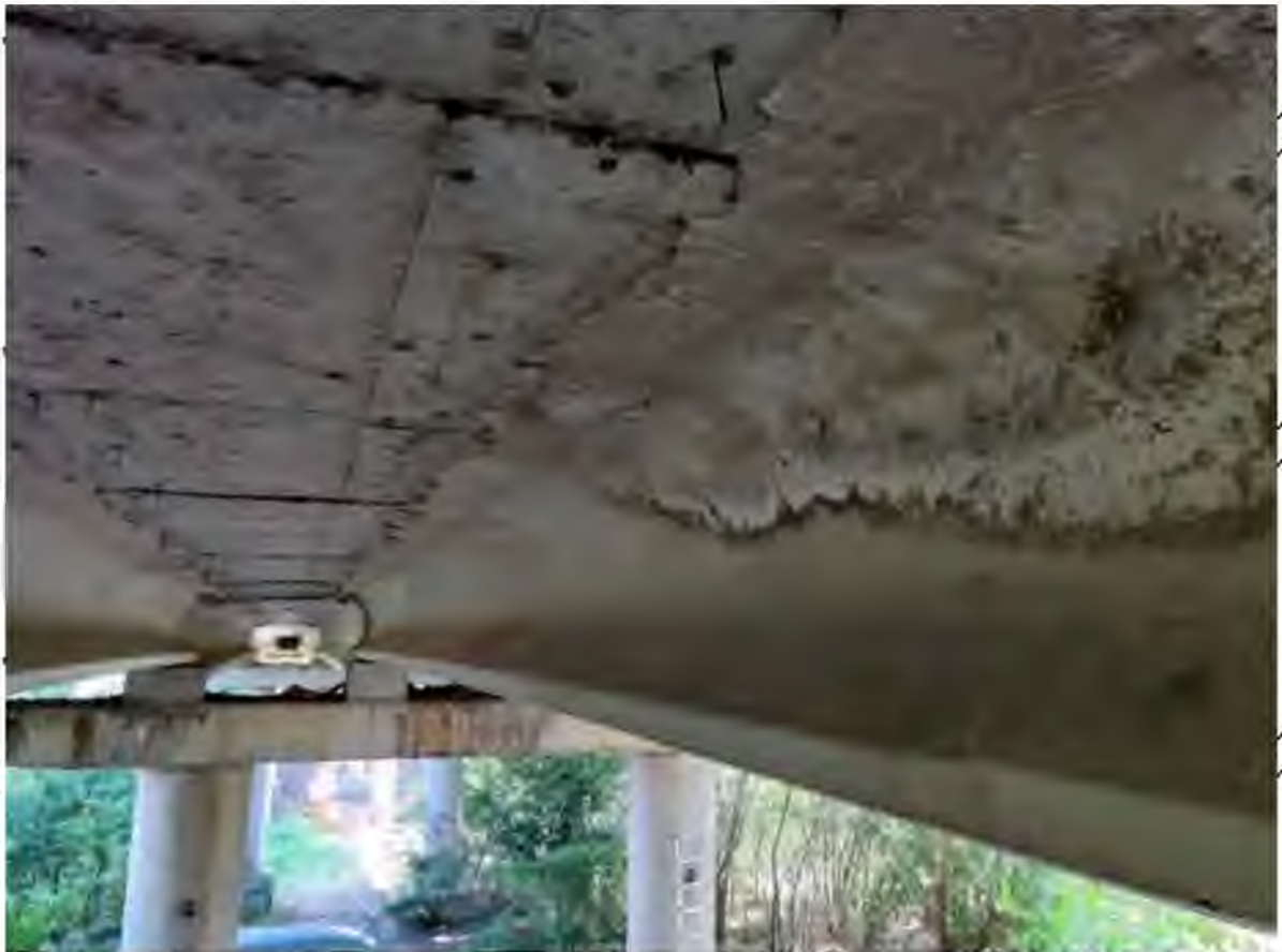
Рисунок 7.9 – значне замокання та виділювання бетону балки В3 у прогоні 1-2 у вигляді висолів
