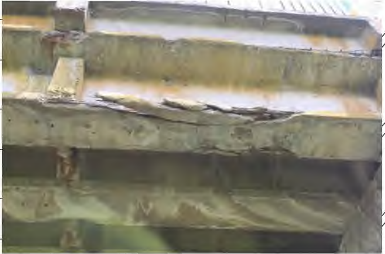
Рисунок 7.5 – Сколи та руйнування захисного шару бетону з оголенням, корозією та розривами дротів попередньо напруженої Сліди інтенсивного замокання балок з подальшим вилугуванням
