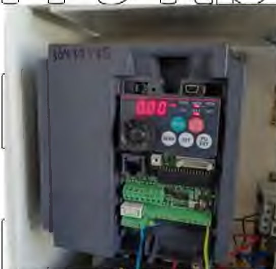
Рис. 3.7. Перетворювач частоти Mitsubishi FR-E740-060
