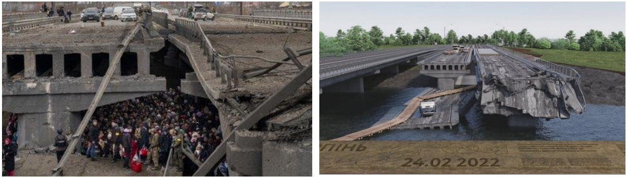
Рисунок 3.2 Зруйнований міст в с. Романівка Київської області
