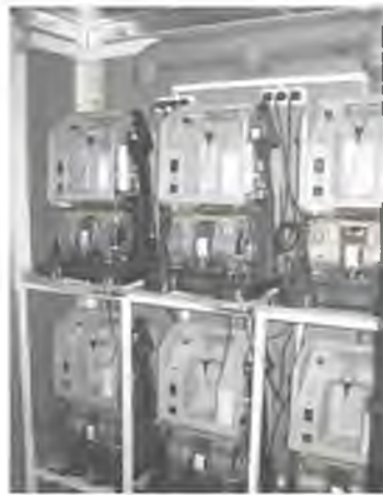
Рис. 1.10. Зовнішній вигляд кисневої станції
