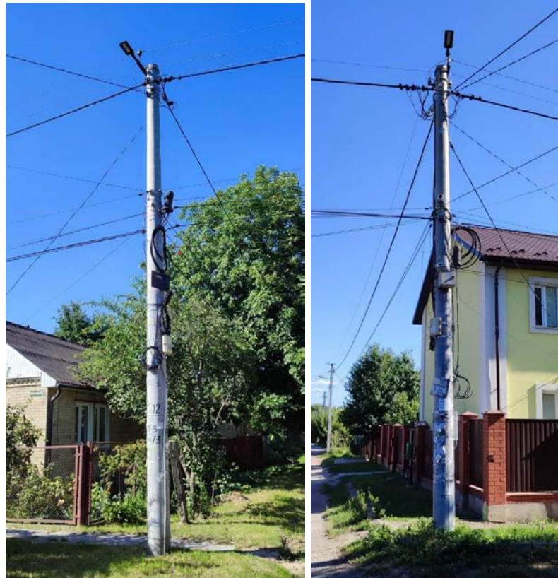
Рис. 3.60. Оптичні муфти встановлені на електроопорі.
