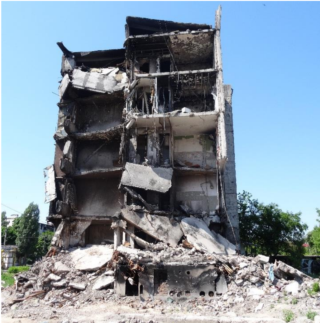
Рисунок 1 – Приклад типового руйнування будівлі після ракетного бомбардування (сmt. Бородянка)
