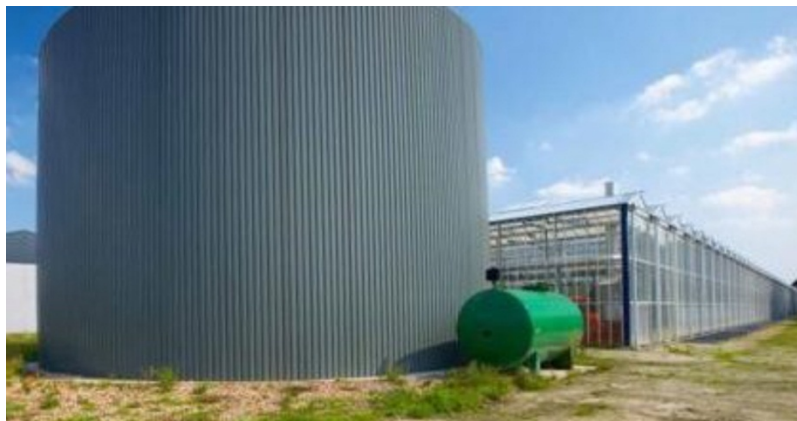
Рис. 1.15. Бак-акумулятор тепличного блоку
