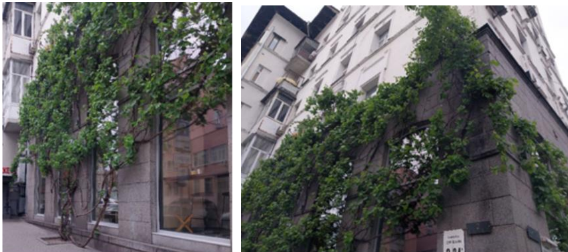
Рис. 3.4. Спонтанне вертикальне озеленення в історичній частині Києва на пров. Георгіївський, буд. 2/24А, (фото автора, травень 2025 р. ).
