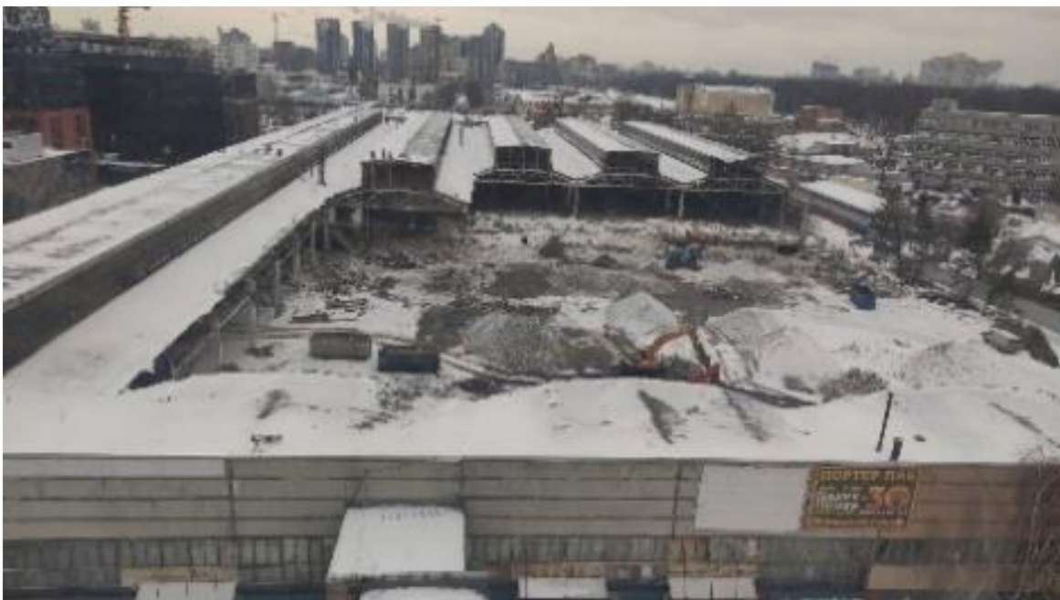
Рисунок 1 – Загальний вигляд конструкцій промислового корпусу, що підлягають демонтажу (вид з 10-го поверху офісної будівлі, що обстежується)
