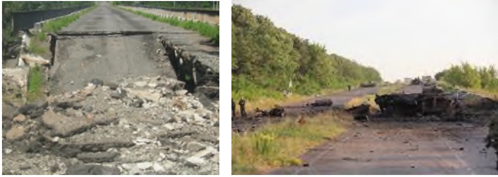
Рис. 2. Пошкоджені автомобільні дороги з асфальтовим асфальто-бетонним покриттями.
