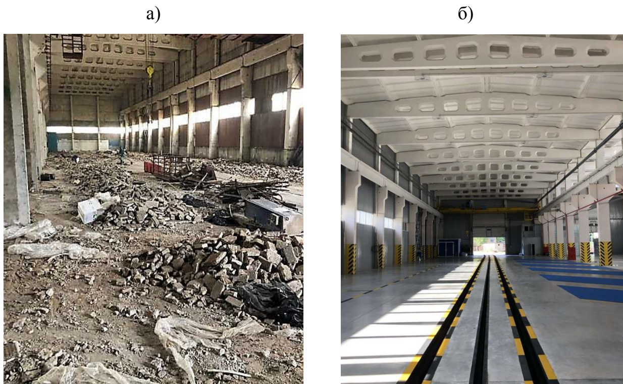
Рис. 1.1. Реконструкція промислового об'єкта: а – технічний стан конструктивних елементів до реконструкції; б - технічний стан конструктивних елементів після проведення реконструкції
