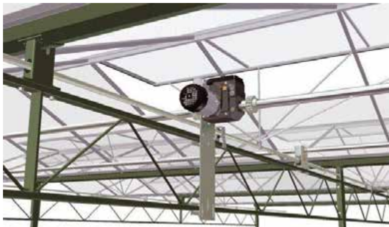
Рис. 3.23. Загальний вид мотор-редуктора в системі вентиляції в теплиці
