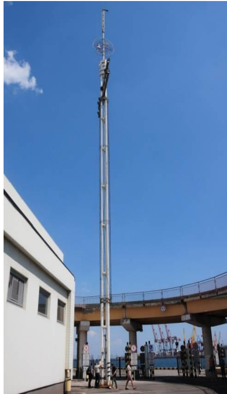
Рис.1. Загальний вигляд прожекторної щогли
