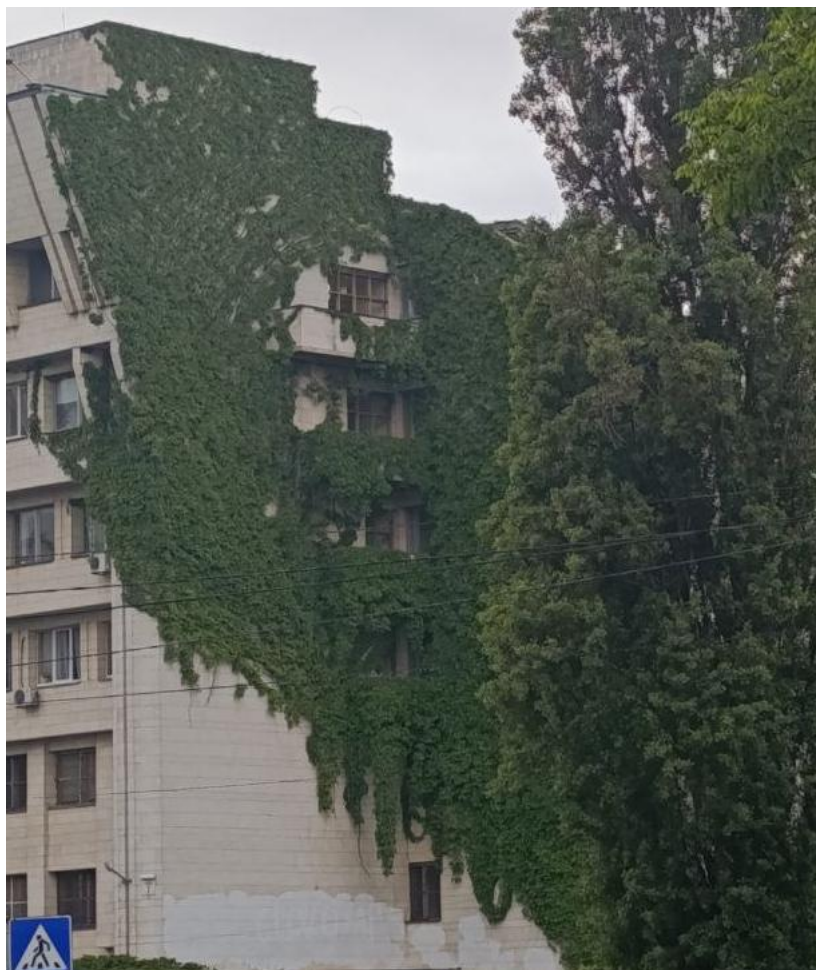
Рис. 1.5. Приклад вертикального озеленення на ННЦ "Інститут біології та медицини" Київського національного університету імені Тараса Шевченка в Голосіївському районі (фото автора, проспект Академіка Глушкова, 2, травень 2025)
