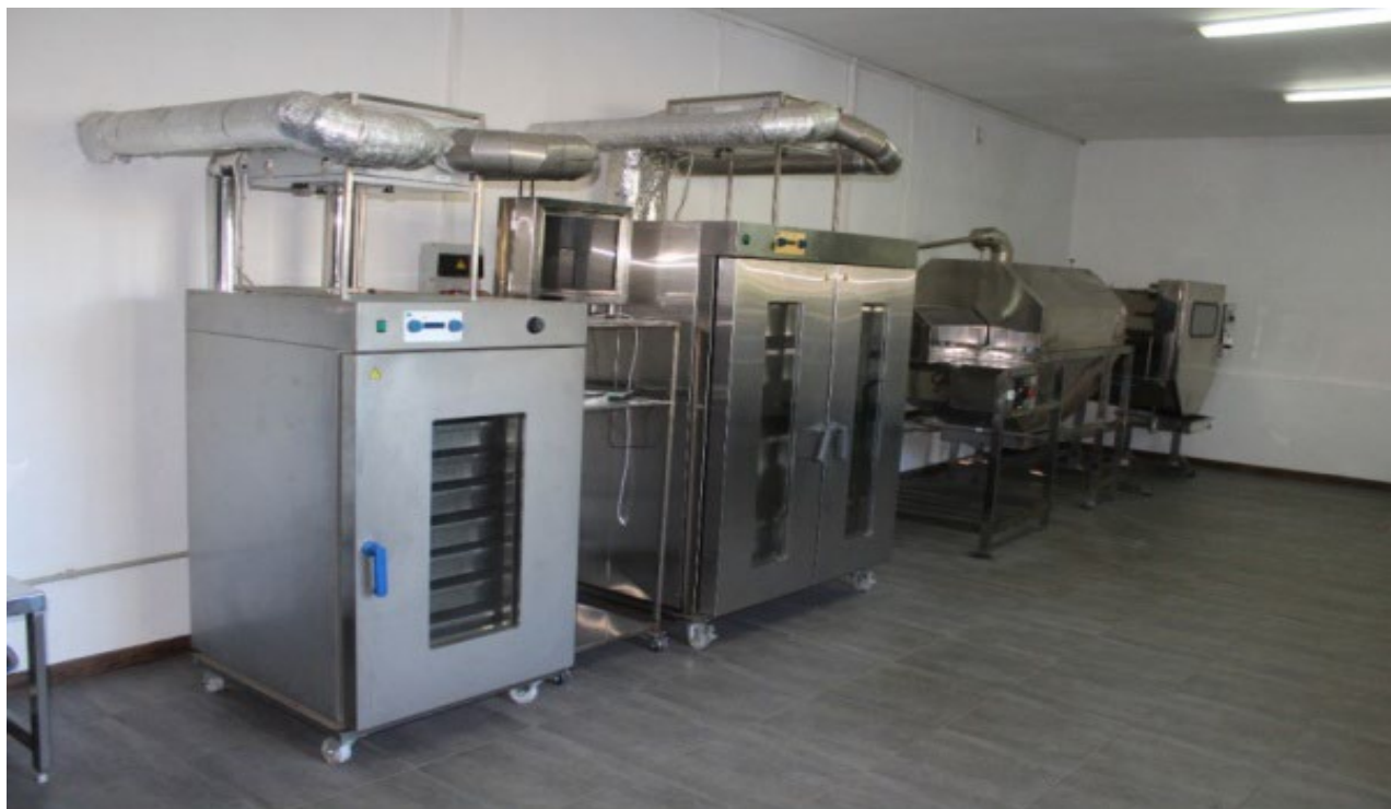
Рис. 4.4. Загальний вигляд сушильного комплексу
