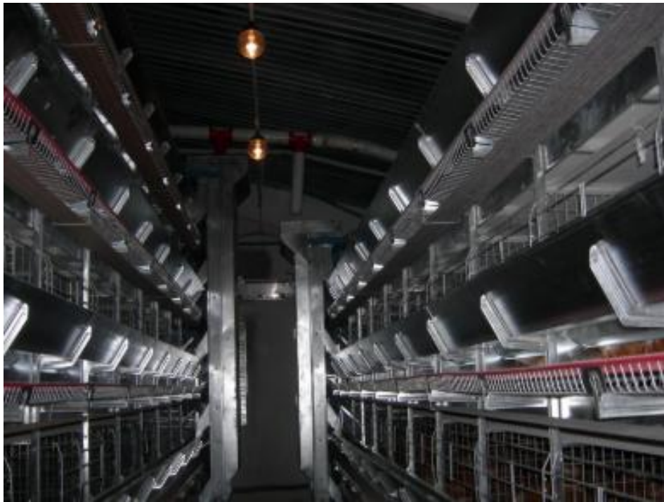
Рис.4. Пташник з встановленим обладнанням серії ОКН
