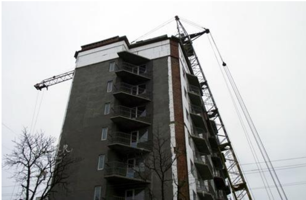
Рисунок 4.1 – Баштовий кран, що впав на ближню будівлю
