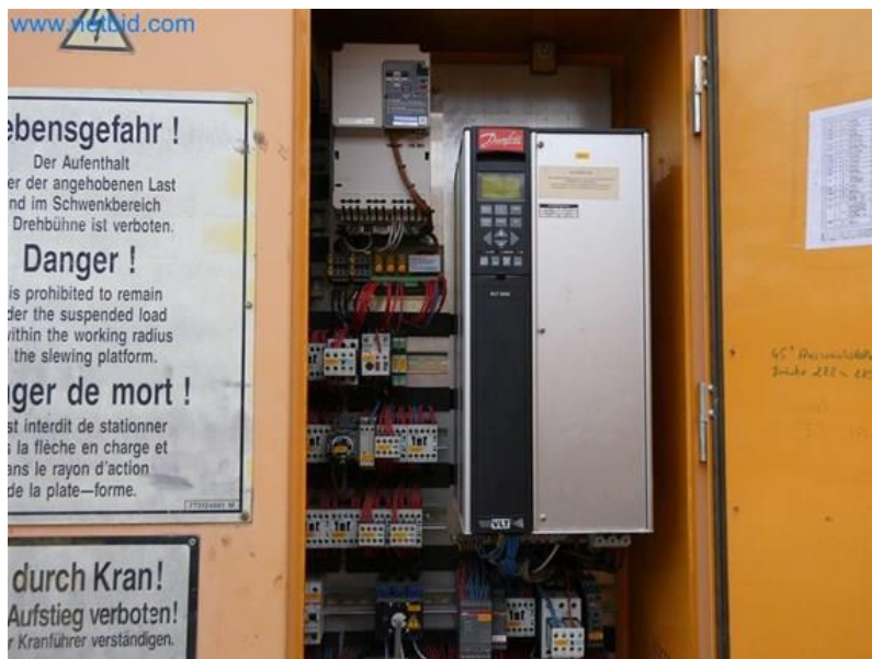
Рисунок 3.2 – Електрична шафа баштового крана фірми Liebherr
