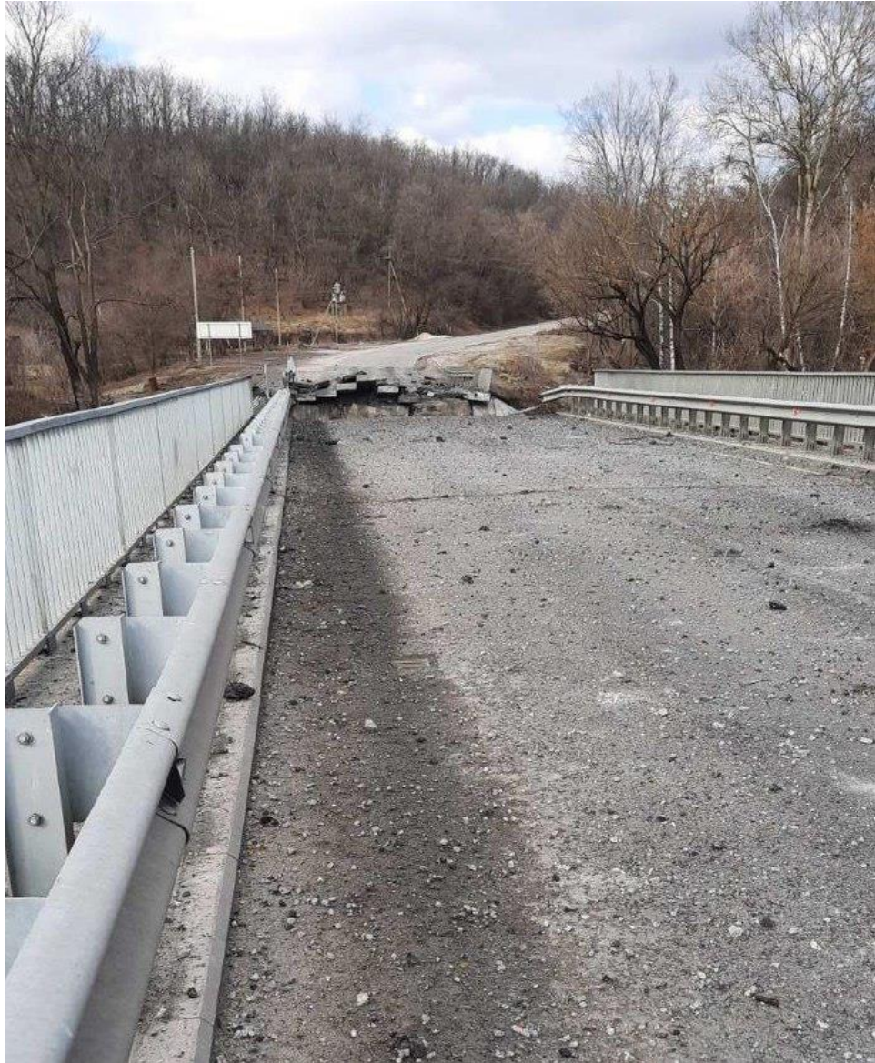
Рис. 2.2. Підірваний міст через річку Сіверський Дінець, що йде через Національний природний парк “Гомільшанські ліси”
