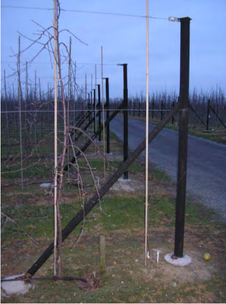
Рис. 39/1. Варіанти закріплення кінцевих стовпів: залізні стовпи з підпоркою, вгорі – закріплені у ґрунті за допомогою бетону; внизу – бетонні стовпчики із підпорками.
