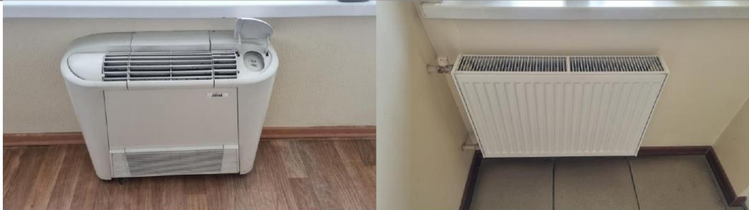
Опалювальні прилади будівлі
