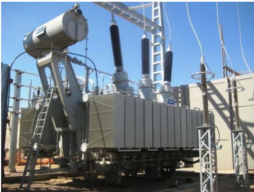
Рис. 2.4. Силовий автотрансформатор напругою 750/330 кВ
