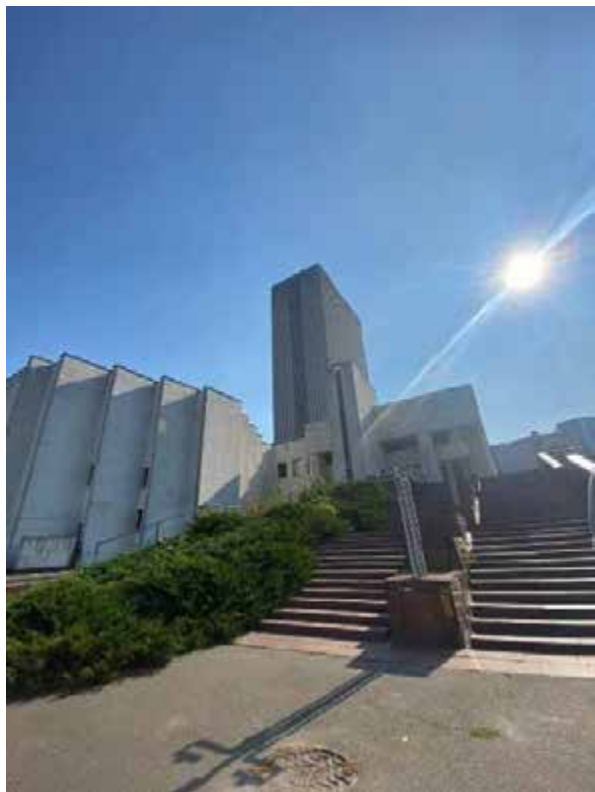
Рис. А.5. Сучасний стан асфальтобетонного покриття у входній зоні (фото автора)
