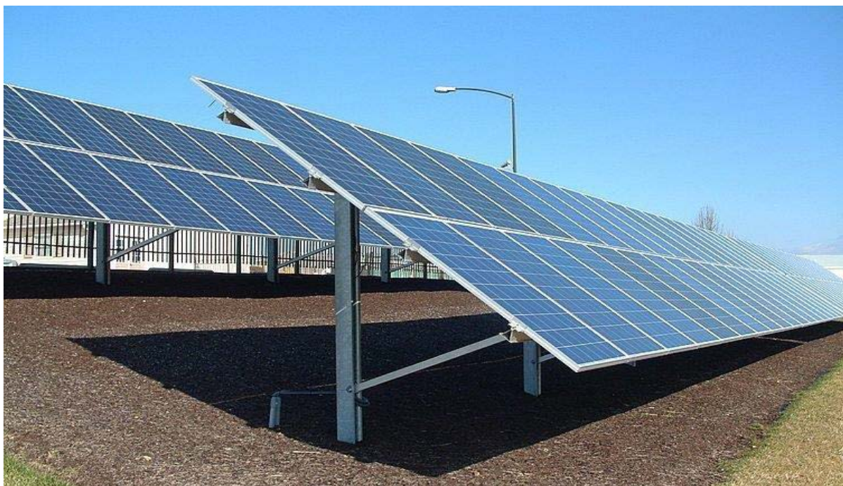
Рис. 2.4. Загальний вигляд наземної сонячної електростанції СЕС
