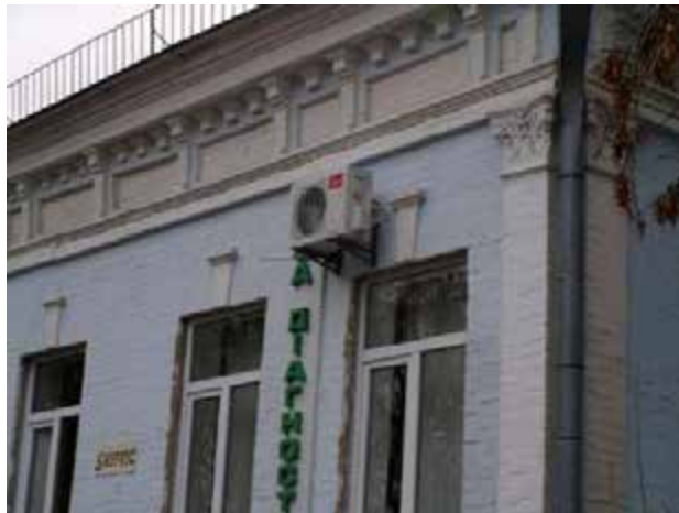
Рис. 4.1. Кондиціонер на фасаді 5 корпусу (фото автора, 2024 р.)
