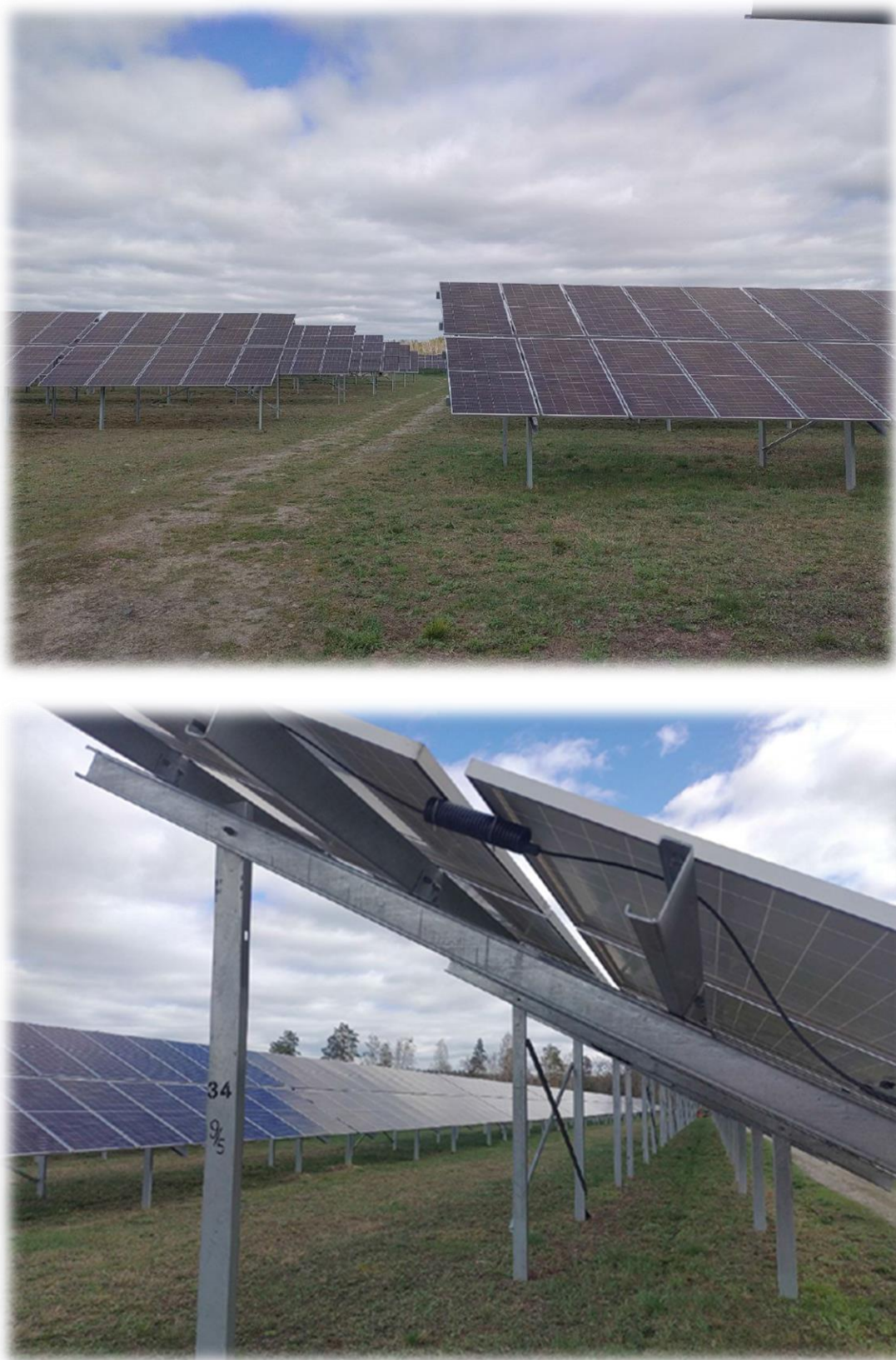
Рис. 5. Елементи сонячної електростанції в межах об'єкту дослідження
