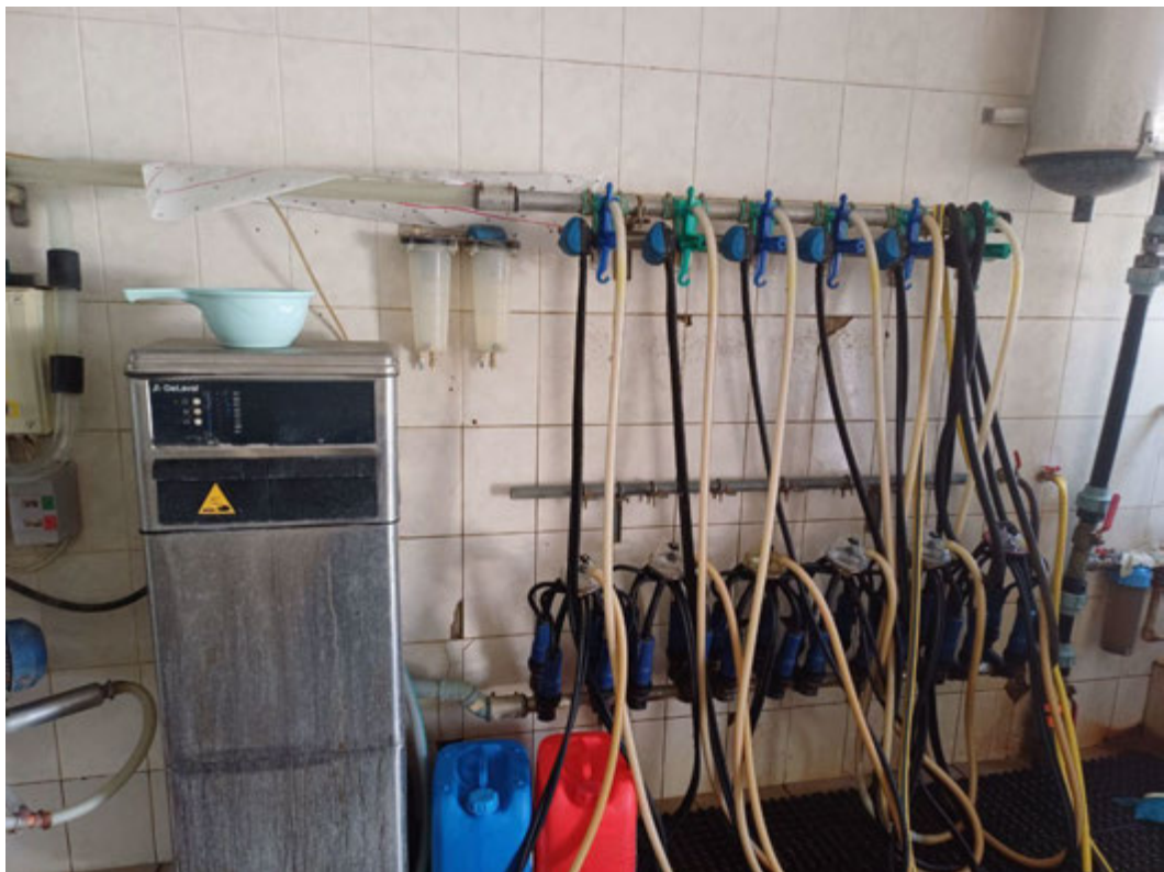
Рис.7 Доїльні апарати на МТФ «Мельники» для доїння в трубопровід
