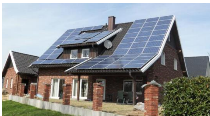
Рис. 1.5. Встановлені сонячні батареї для обігріву будинку
