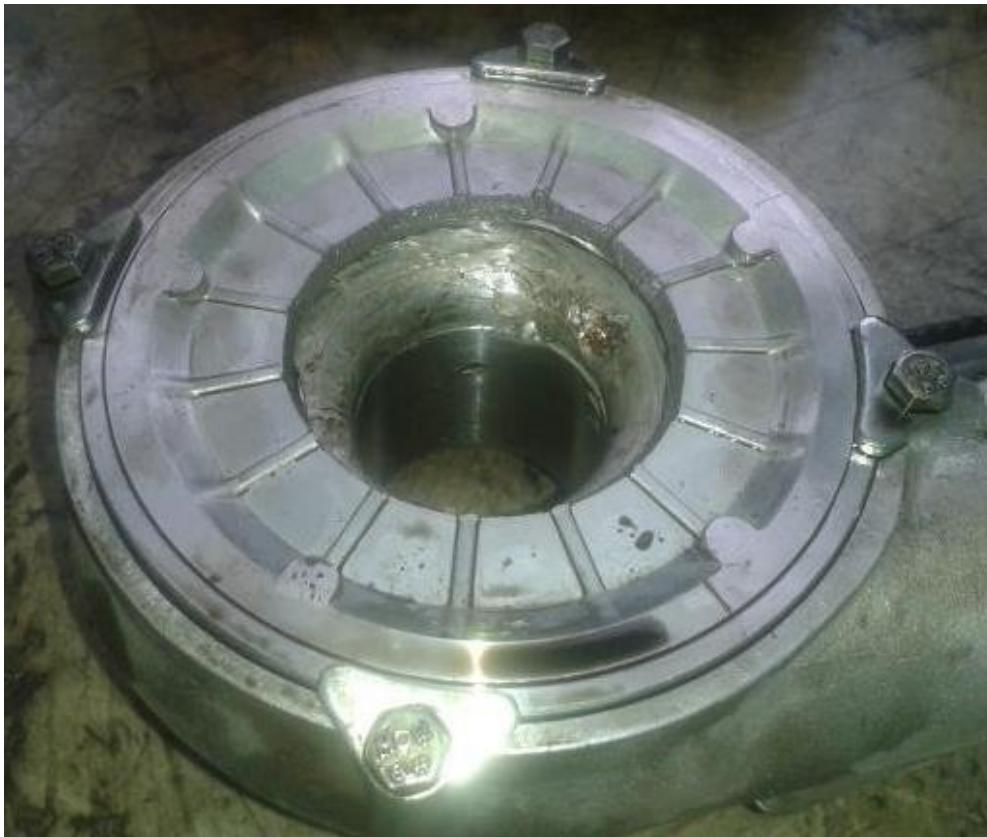
Рис.3.3 – Зруйнований повітропровід компресорної частини
