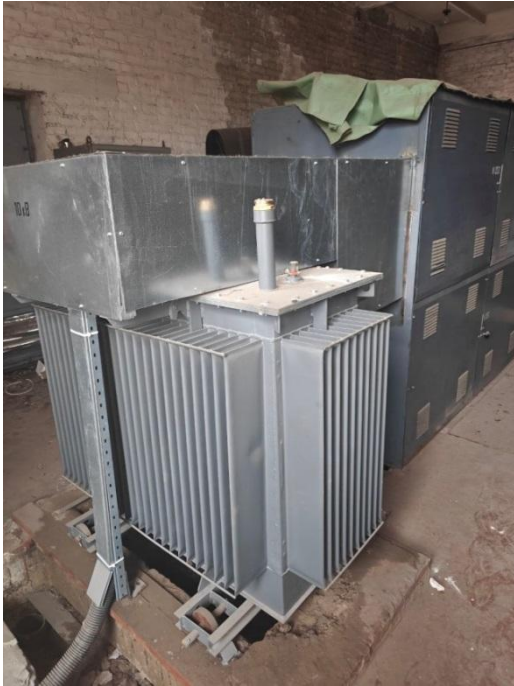
Рис. 4.1. Силовий трансформатор ТМ-8 630/10 на РП-203
