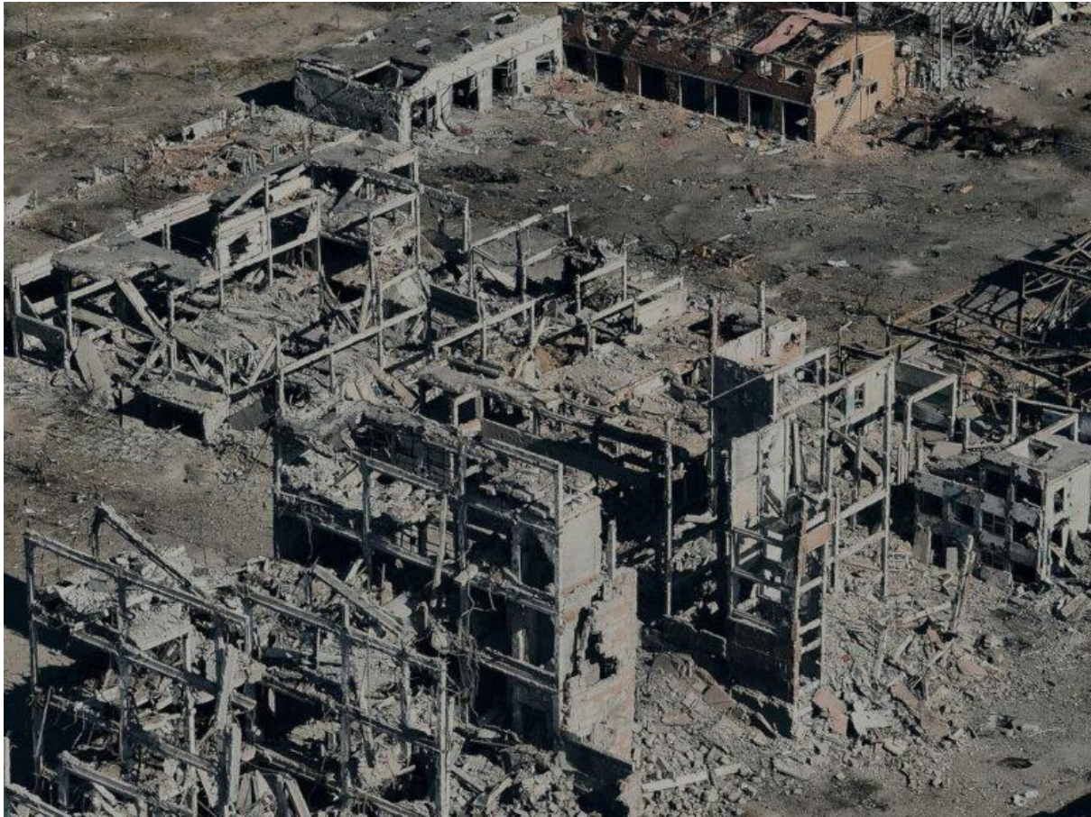
Рисунок 8. Зруйнований Вовчанськ, як приклад населеного пункту, що зазнав майже тотальної руйнації внаслідок атак рф [10]
