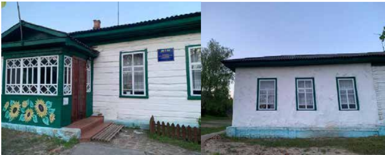
Рис. 2.6. Будівля школи що потребує косметичного ремонту ( фото автора)
