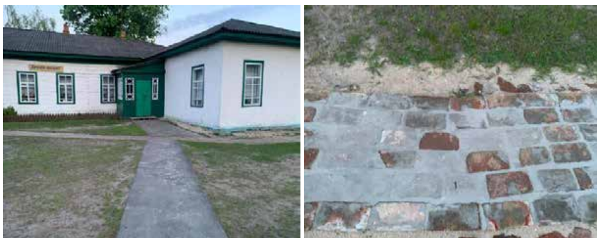
Рис. 2.7. Доріжки які потребують ремонту (фото автора)
