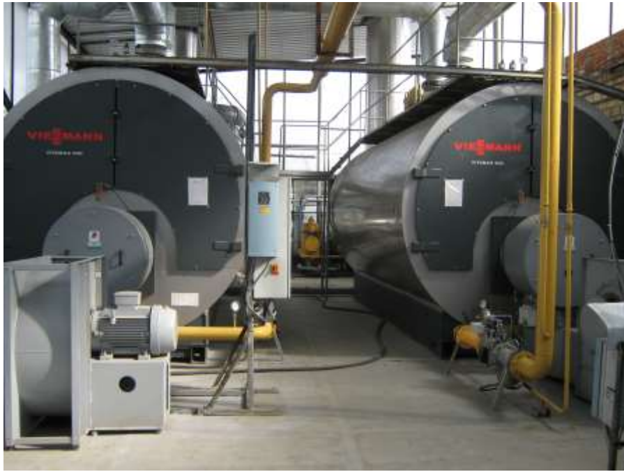
Рис. 1.5. Котли Viessmann Vitomax 200 для опалення блочної теплиці з системою відбору CO 2 для підживлення рослин
