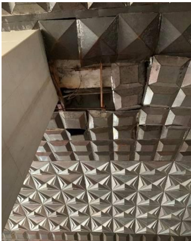
Рис. 1. Замокання елементів перекриття та підвісної металеві стелі на першому поверху, корозія сталевих елементів кріплення стелі, внаслідок протікання інженерних мереж в осях «Б - В», «7 - 8»
