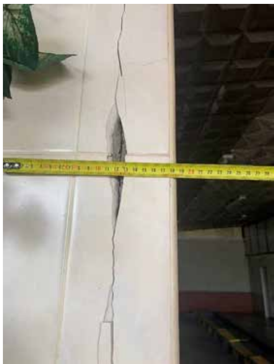
Рис. 2. Вертикальна тріщина по колоні перерізом 400 x 600мм на 1 поверху приміщення гаражу на перетині осей «8», «Б» з шириною розкриттям 1,0-3,0 мм, довжиною 1,37 м: а) – за результатами обстеження 2016 року; б) – теж саме 2021 року.
