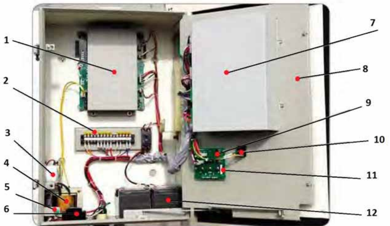
Рис.4.4.2. Розташування в щіті АСУ 1. Плата інтерфейсу введення/виведення 2. Клемна колодка 3. Розетка змінного струму 220 В 4.Power Tr. 5. Двері відкриті SW 6.MCB 7.FTU 8. Внутрішні двері 9. Акумулятор V. I. Тестовий термінал 10. FTU On/Off SW 11. Акумулятори
