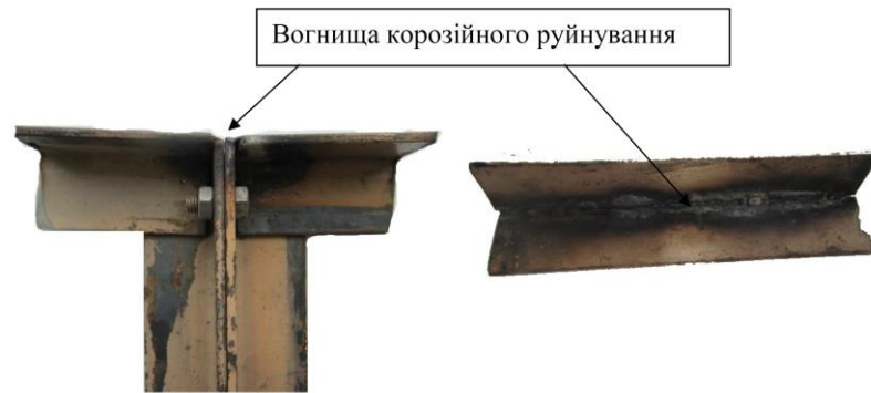
Рис. 1.12. Місця корозійного руйнування
