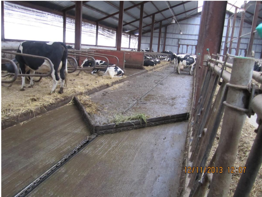
Рис. 1.7. Загальний вигляд прибирання гною скреперною установкою УС-120
