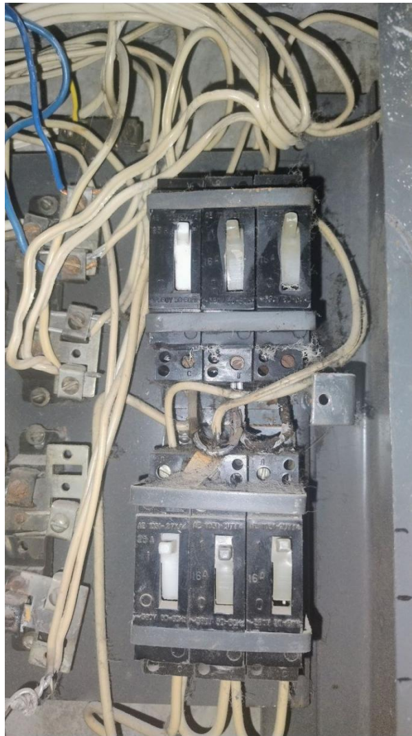
Рис. 1.1. Наслідки ослаблення контакту алюмінієвих провідників у розподільчому щиті.
