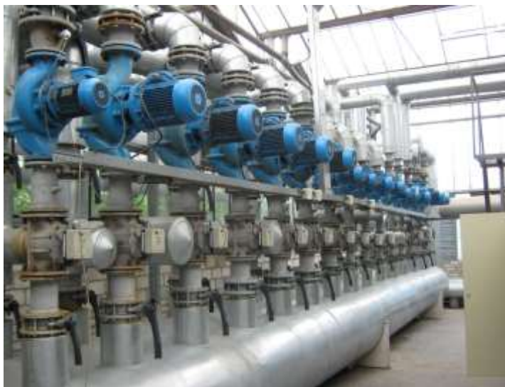
Рис. 1.6. Зовнішній вигляд змішувальної групи системи обігріву тепличного блоку (ПАТ Комбінат "Тепличний")
