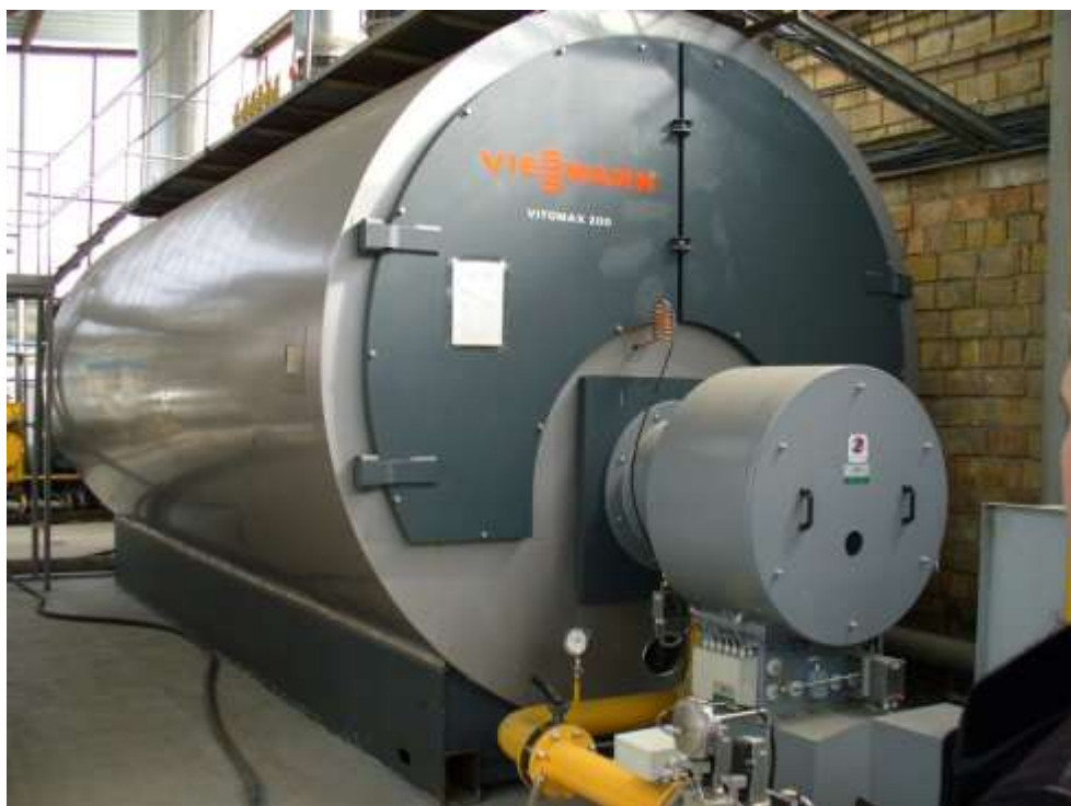
Рис. 1.7. Водогрійний котел Viessmann типу Vitomax 200 WS (ПАТ Комбінат "Тепличний")
