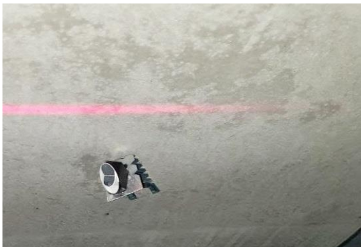
Рис. 2.12 Загальний вигляд пункту спостереження за деформацією
