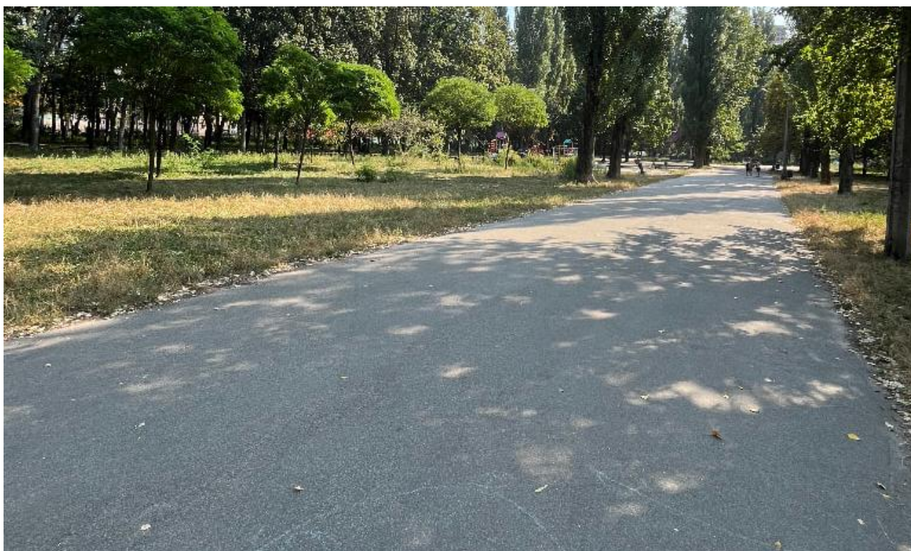
Рис. 2.3. Асфальтне покриття алеї парку (фото автора 27.08.2024)
