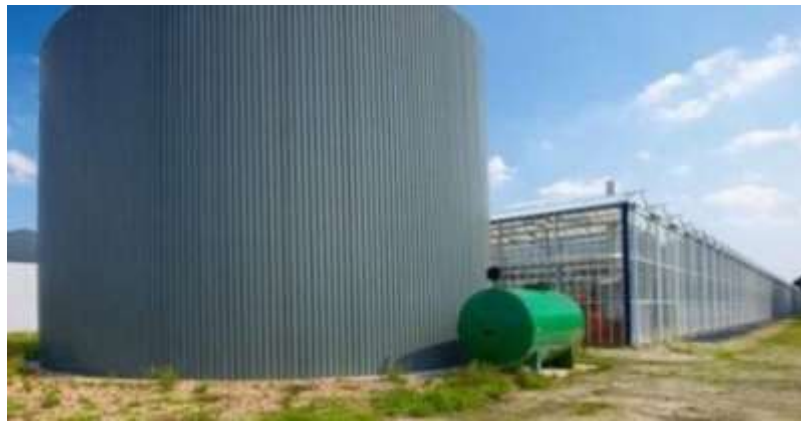
Рис. 1.8. Бак-акумулятор тепличного блоку
