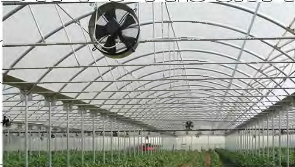
Рис. 1.10. Загальний вид тепличної вентиляції
