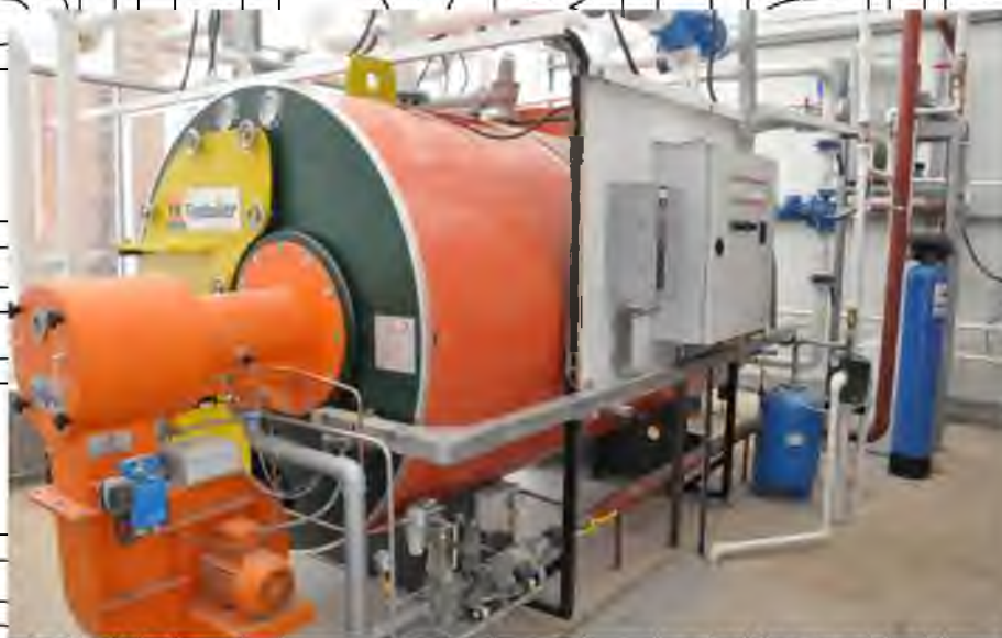
Рис. 1.4. Загальний вид котлу опалення сучасної теплиці
